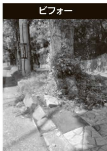
木の根が歩道を押し上げている危ない歩道
